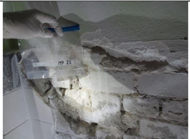
Nr. 144, 1. OG Sanitärrume: Fliesenmörtel → P 22
