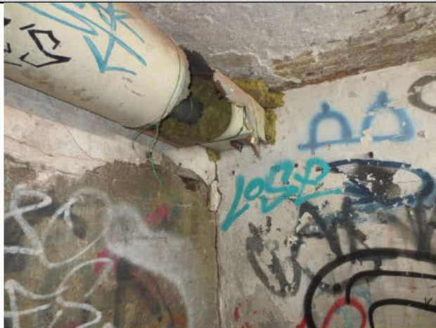
Nr. 140, altes UG: Mineralwolle Leitungsdämmung
