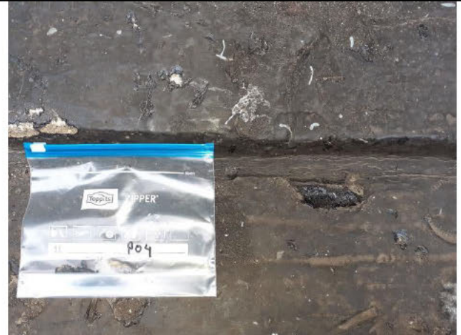
Nr. 140/144, Außenwand: Wand/ Sockeldichtung → P 04
