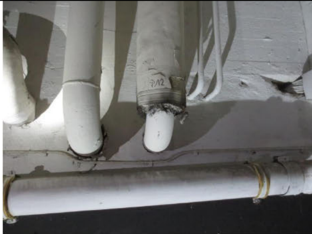
Nr. 144, Tiefgarage: Mineralwolle Leitungsdämmung mit KMF / Kat 1B → P 12
