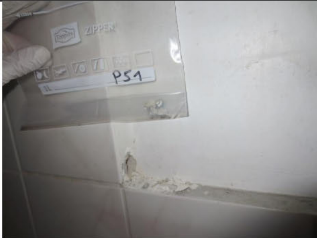
Nr. 144, 3. OG Sanitärraum: Fliesenkleber → P 51
