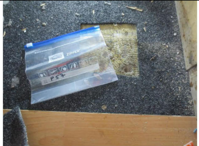
Nr. 144, 4. OG Boden: Kleber/Ausgleichmasse unter Laminat → P 57
