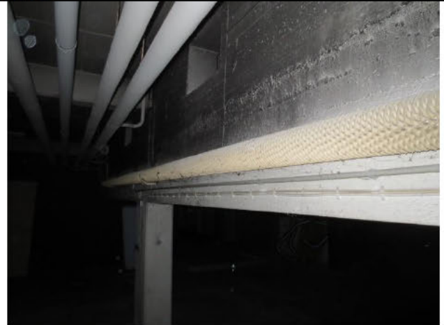
Nr. 144, Tiefgarage: alte Heizkörper oberhalb Durchfahrten
