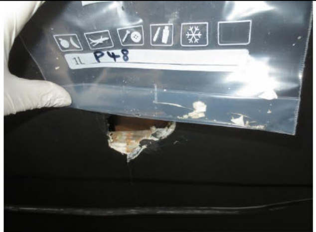
Nr. 144, 3. OG Deckenplatten: Spachtelmasse → P 48
