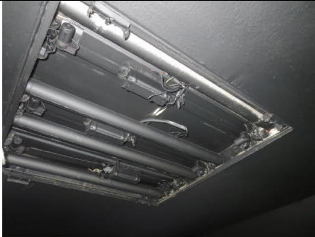
Nr. 144, 3. OG Decke: Leuchtstoffröhren
