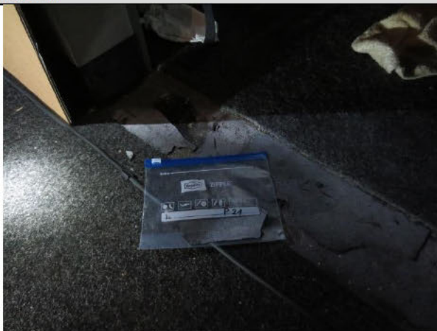
Nr. 144, 1. OG Fußboden: Belag und Kleber mit Asbest! → P 21
