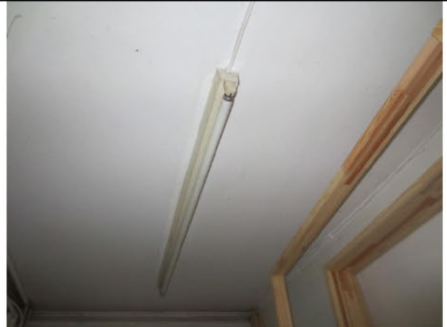
Nr. 144, 1. OG Decke: Leuchstoffröhren
