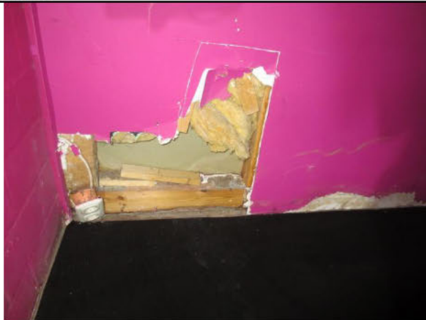
Nr. 144, KG: Mineralwolle Leichtbauwände
