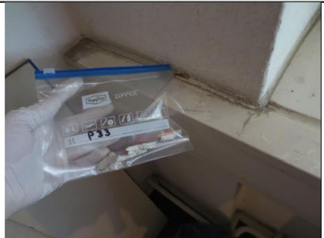
Nr. 144, 2. OG: Fugenmasse Fensterbank → P 33
