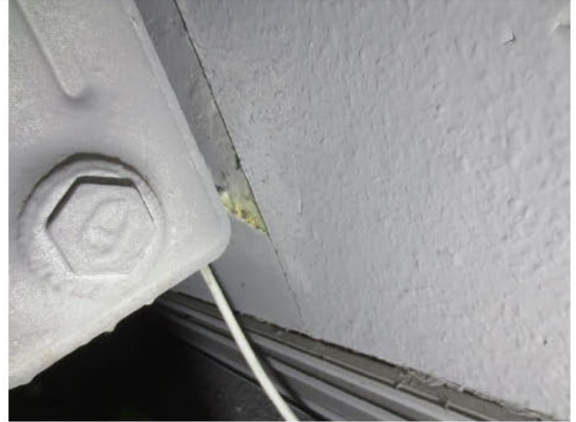
Nr. 144, 1. OG Südtrakt: Pappe hinter Gliederheizkörper
