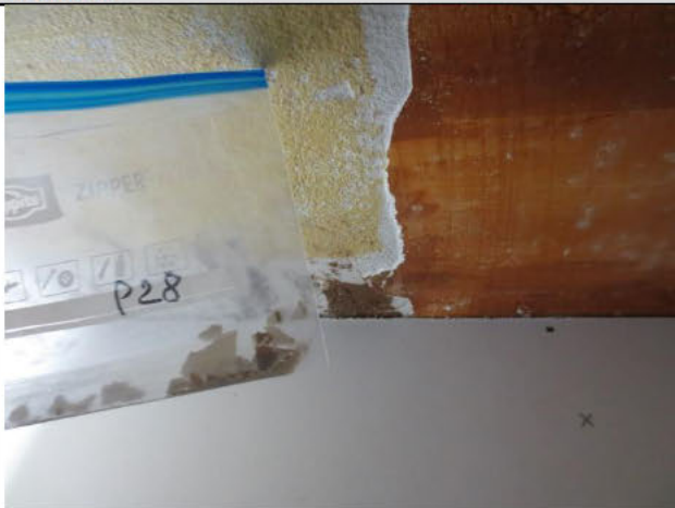
Nr. 144, 2. OG: Deckenputz → P 28
