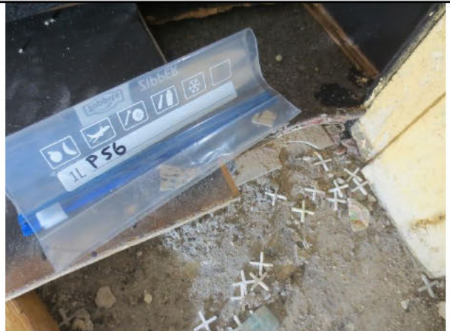
Nr. 144, 3. OG Fußboden: Belag und Kleber mit Asbest! → P 56
