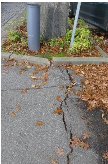
Abbildung 62: Riss in Asphaltdecke (Eckhard Zemke, Baumsachverständigenbüro Zemke)
