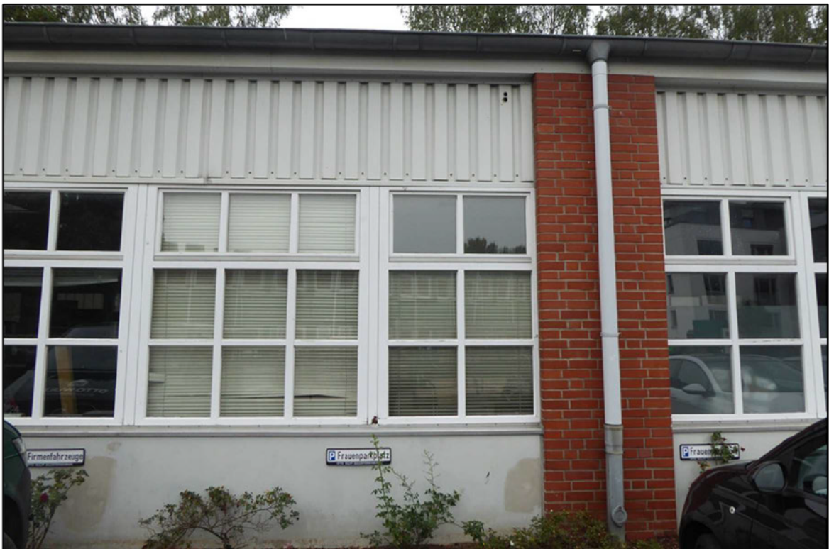
Abbildung 8: Fassade der Werkstattgebäude. Verkleidung ohne Lücken. Im Innern ohne Verkleidungen (03.09.2020)
