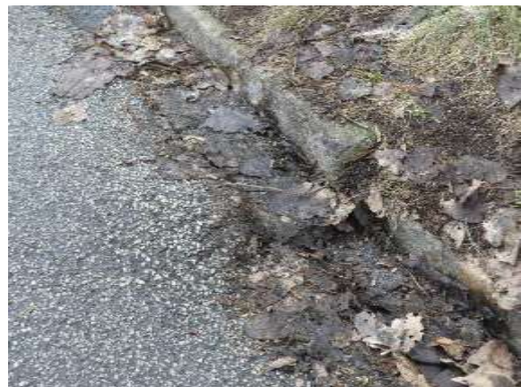
Angehobener Bordstein und Asphaltanhebungen
