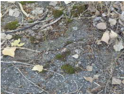
Asphaltriss, als Hinweis auf Wurzel- einwachsungen
