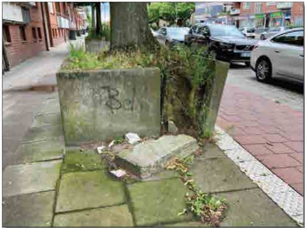
Abb. 4 Sanierbedürftige Baumkübel am Mühlendamm
